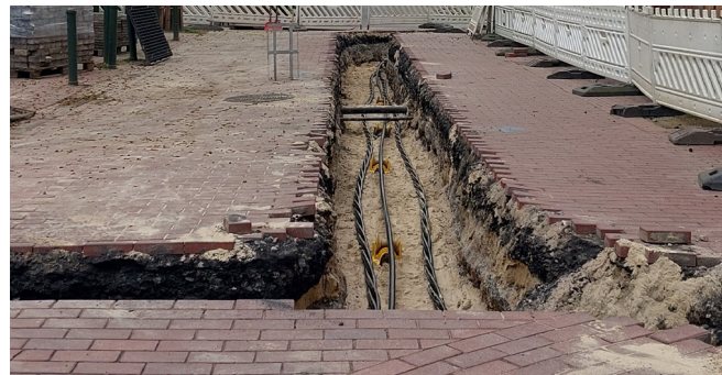
Eingriff durch Versorger
